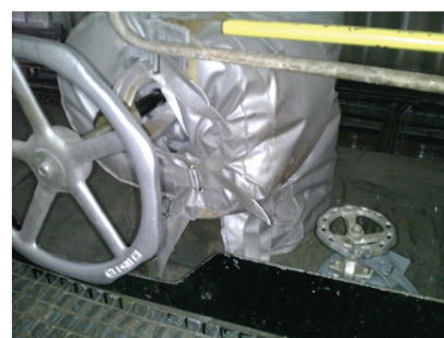
Manchon isolant spécial sur vanne vapeur 12 bars
