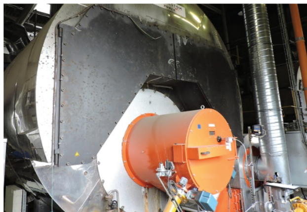
Figure 1 : Chaudière gaz de production vapeur
