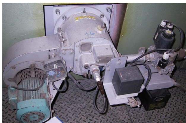
Brûleur torche avec grille d'entrée d'air comburant nettoyée
