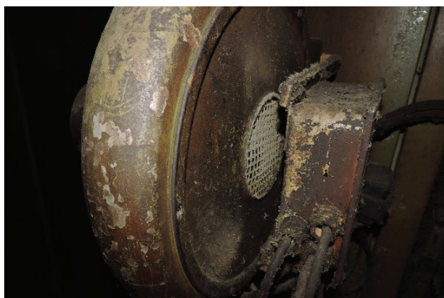
Brûleur torche sur un four, dont la grille d'entrée d'air comburant est colmatée
