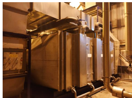
→ Échangeur de récupération de chaleur
