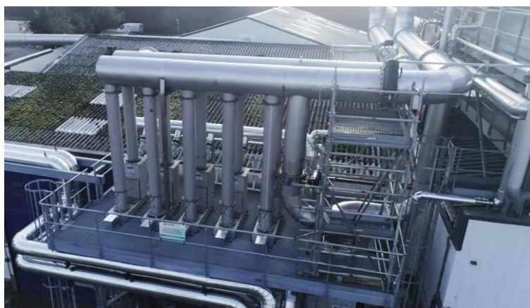
→ Échangeurs installés pour traiter les buées
