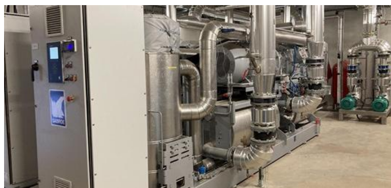
Vue de la pompe à chaleur à double étage
