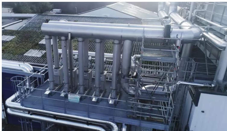
→ Échangeurs installés pour traiter les buées
