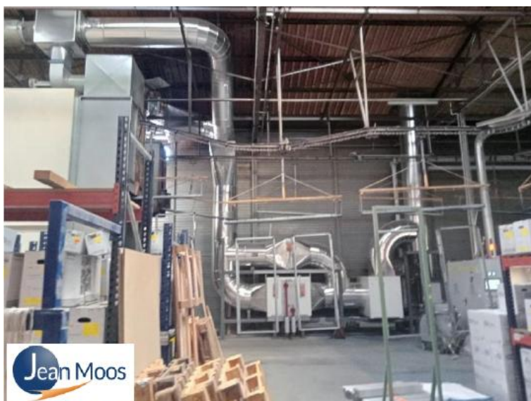
→ Echangeur de récupération fumées / eau + conduit d'extraction en toiture
