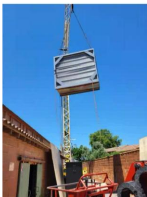
→ Batterie froide de la PAC
